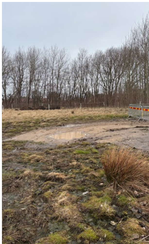
Figur 6. Foto av det vattensjuka området där vattenläckan uppdagades. (Fotonr: 2026-36-2). Mot norr. Foto: Johanna Olsson.
